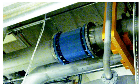
Rosemount 8700 magneettinen virtausmittari asennettuna
