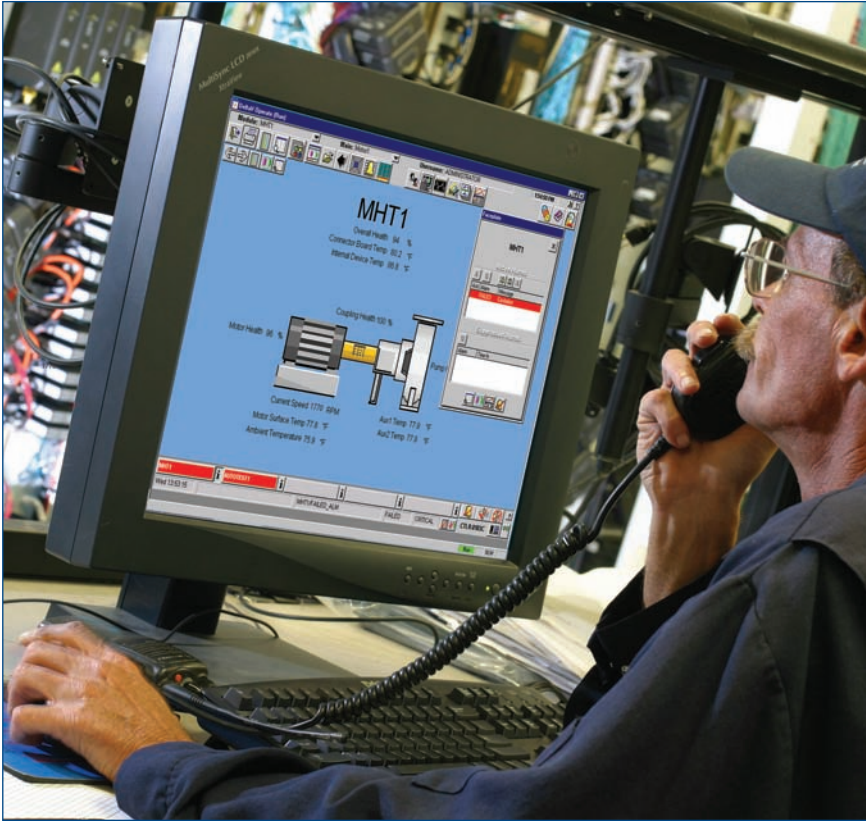
PlantWeb Alerts geben dem Anlagenfahrer klare, eindeutige Hinweise über entstehende Probleme an einer DeltaV Bedienstation.
