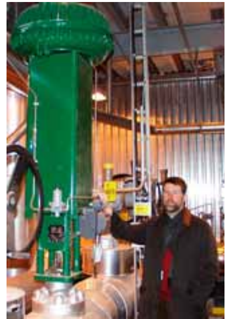
Seppo Paavola asettui "mittatikuksi" Fisherin massiivisen korkeapaineventtiilin vierelle
