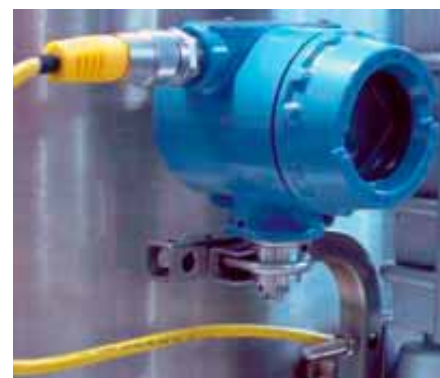
Prosessissa FF-kenttälaitteen erottaa parhaiten kirkkaankeltaisesta FF-kenttäväyläkaapelista
