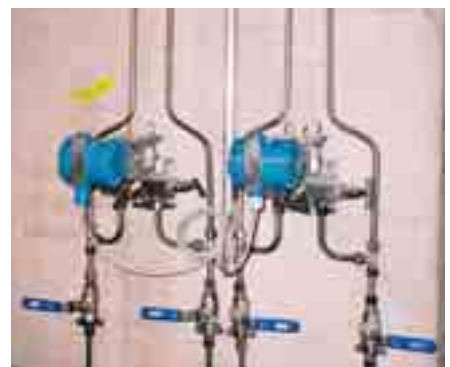
Kajaanin Prosessimittaukset Oy:n ja Rosemountin sinisiä lähettimeä mittauksissa prosessissa. Ylhäältä Kajaanin uusi pyörivä lähetin, lapalähetin ja näytteenotin sekä alhaalla Rosemount lähettimeiden näyttävä asennus.
